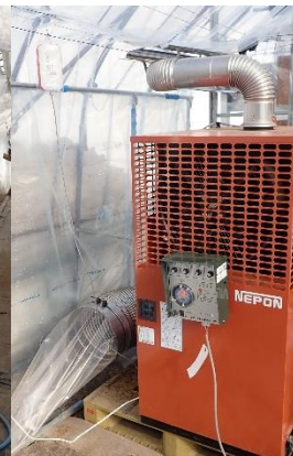
温室監視 （ボイラー故障警報）
